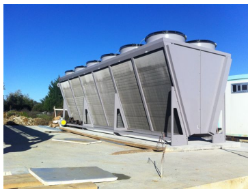
Sondes et aérotherme
