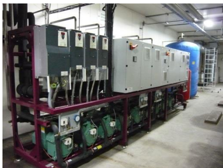
L'installation de froid négatif Crédit photo : ADEME Rhône-Alpes
