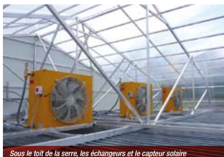
Sous le toit de la serre, les échangeurs et le capteur solaire
